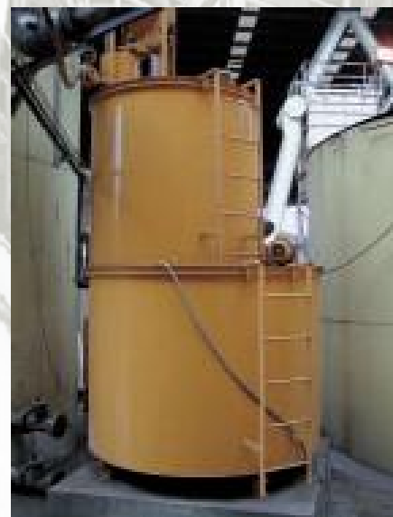
Estación de Floculante.
