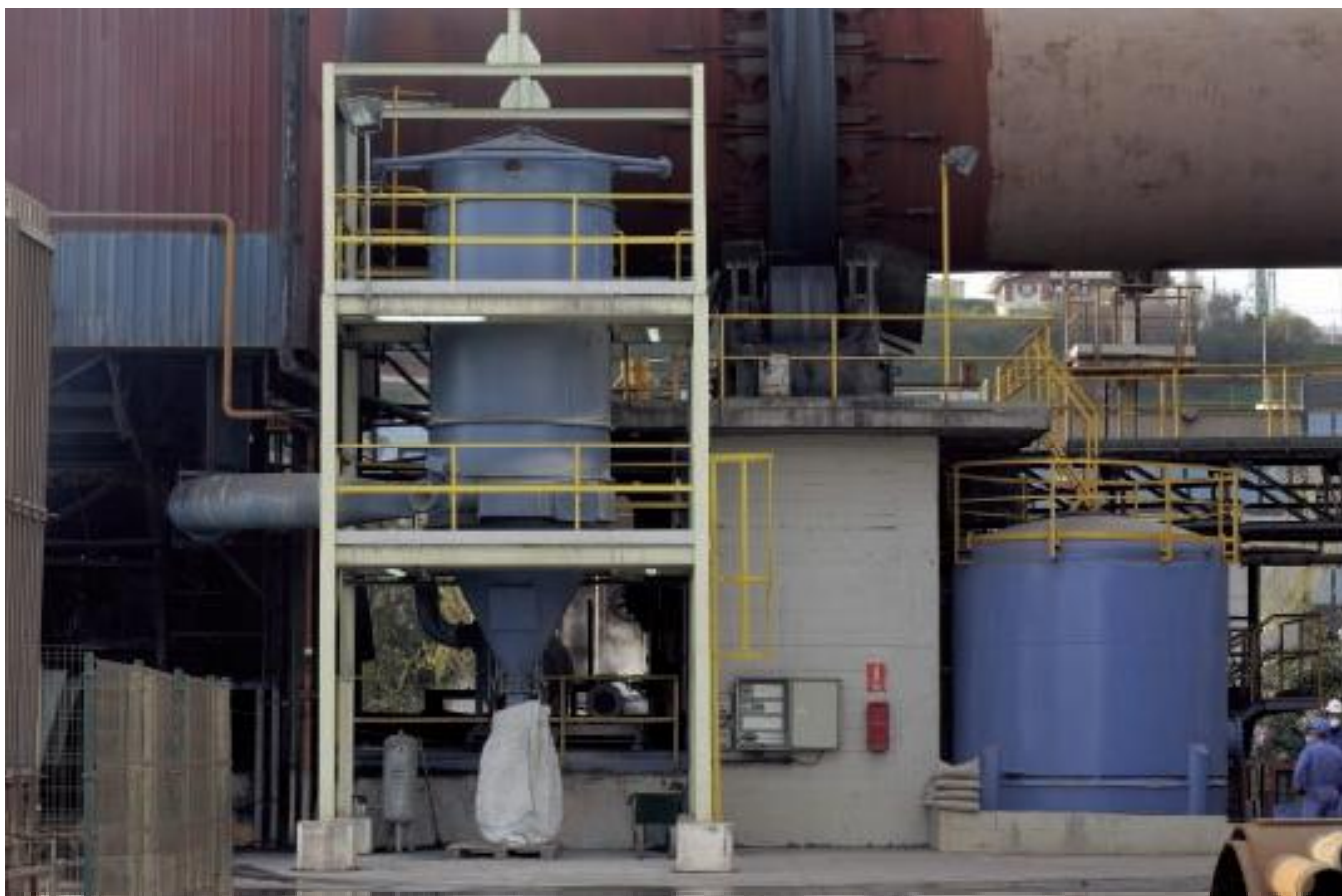
Nuevo filtro de mangas.
