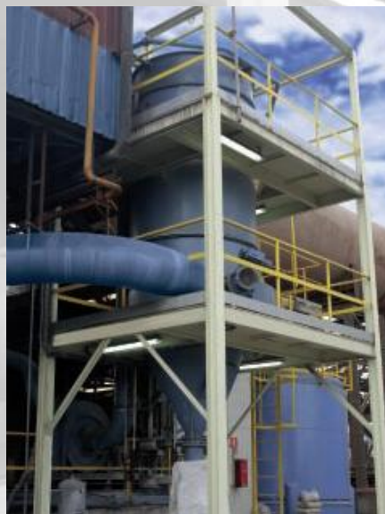
Nuevo filtro de mangas.
