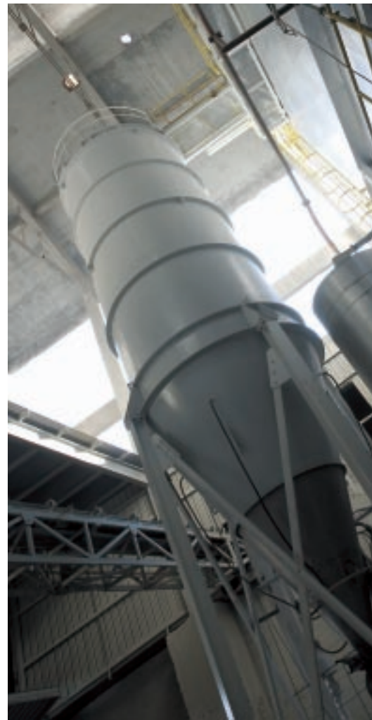
Nuevo sistema de depuración de gases.
