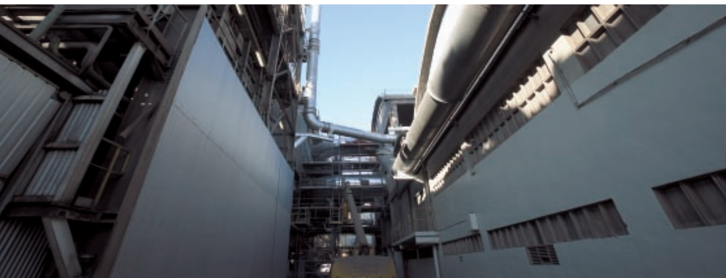
Tuberías de conexión al nuevo sistema de depuración de gases.
