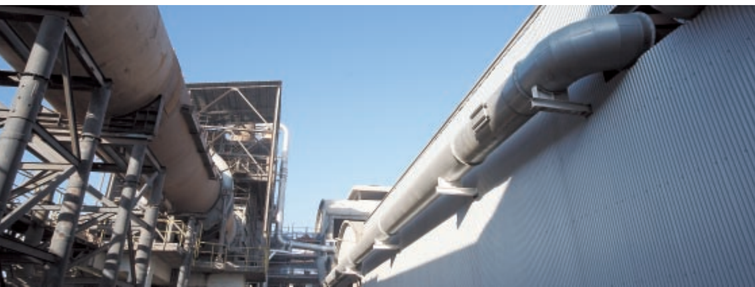
Horno Waelz y tuberías de conexión al nuevo sistema de depuración de gases.
